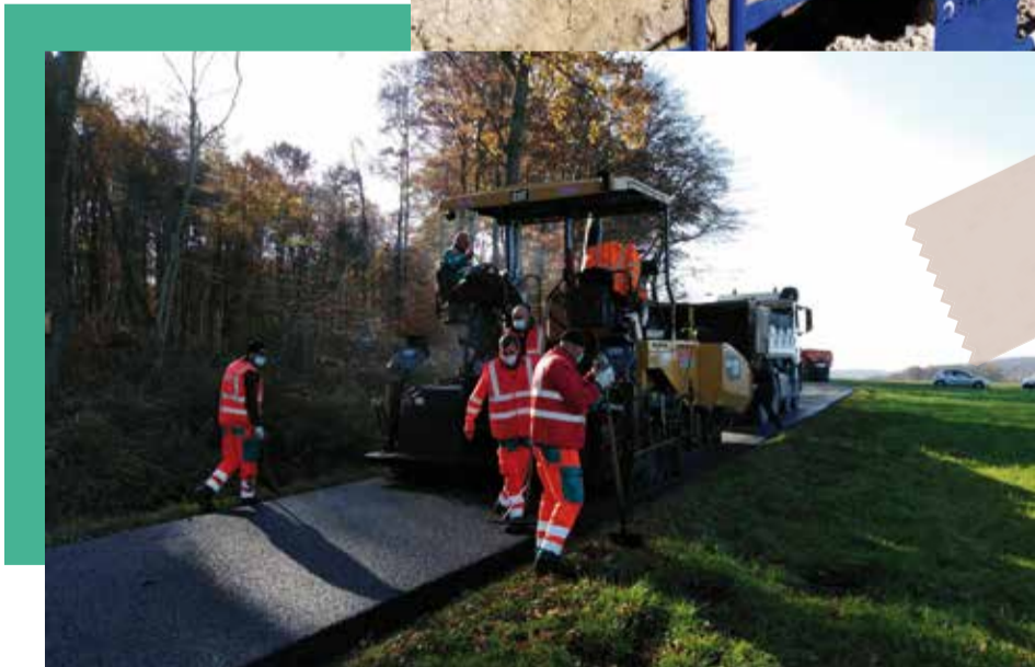
Réfection de la voirie intercommunale entre les communes de Courcelles et Réchesy
